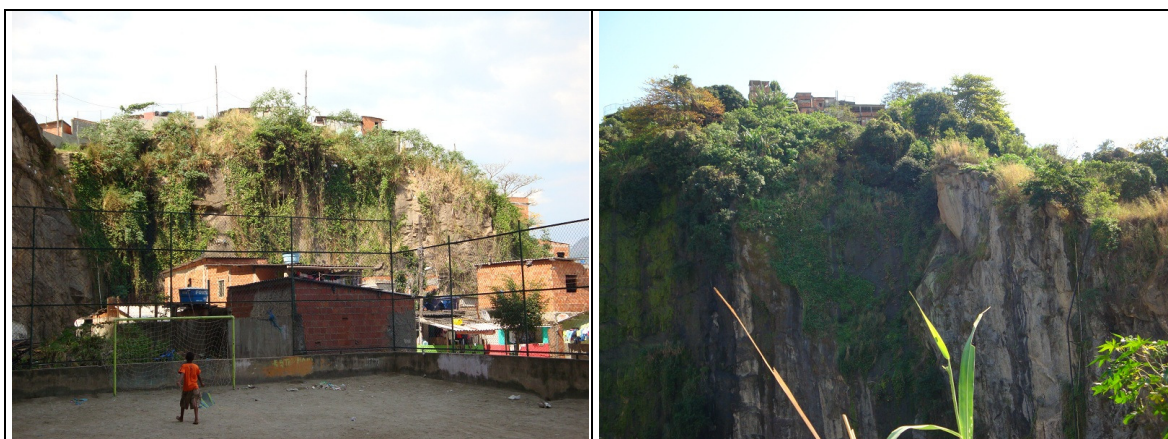
Fotos 1 e 2 – Parte superior do talude coberta por vegetação
