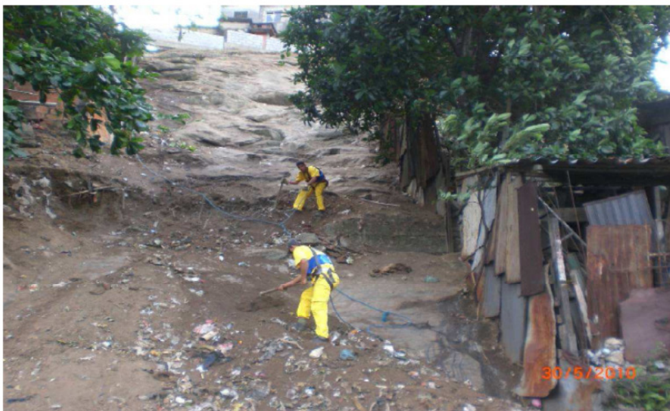
FIGURA 9 – TRABALHADORES FAZENDO A RETIRADA DE MATERIAL DECORRENTE DE UM DESLIZAMENTO DE SOLO E LIXO.
